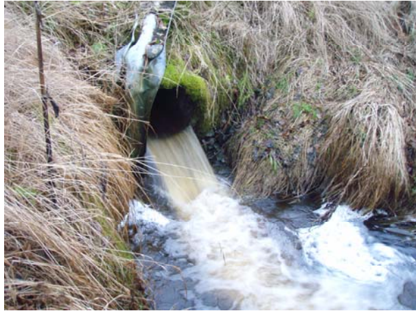
Fig. 5.2.3. Bekken passerer i et rør under Lysernveien. Røret ligger høyere enn bekkeløpet og danner på den måten et vandringshinder for vannlevende organismer. Foto: Ola Wergeland Krog
