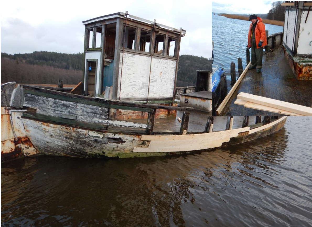
Figur 3. Wirgo hadde skader i skroget slik at den tok inn vann da den skulle lenses. Skadene måtte derfor laskes. Innfelt bilde med altnuligmann Even Rud som hjalp til med den første tømningen. Foto: Ola Wergeland Krog.
