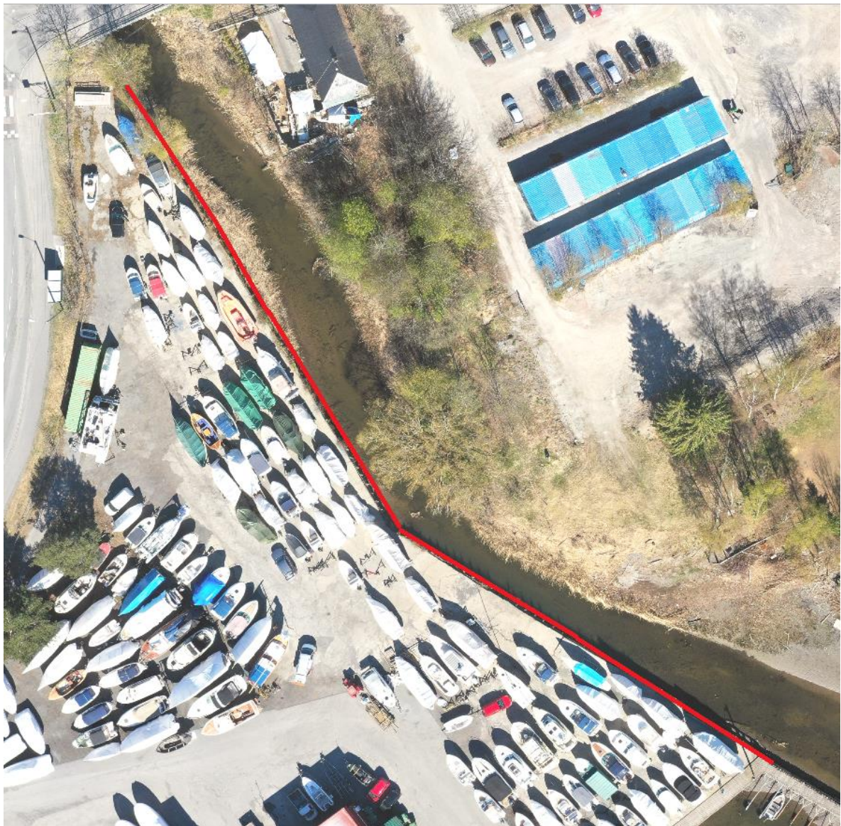
Figur 3. Kaifronten som må utbedres er markert med rød strek. Lengden på tiltaket er avkortet i forhold til opprinnelig søknad og omfatter nå kun selve kaifronten. Bakgrunnsbildet er basert på dronefoto tatt den 21. april 2020. Foto: Ola Wergeland Krog.
